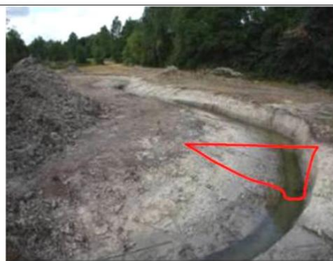
Cours d'eau avec méandre et lit emboîté quasiment en «V» : après travaux (source : BRAMARD, La restauration morphologique de nos rivières )
